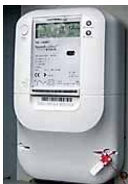
Box mit GPRS-Sender und PLC System
